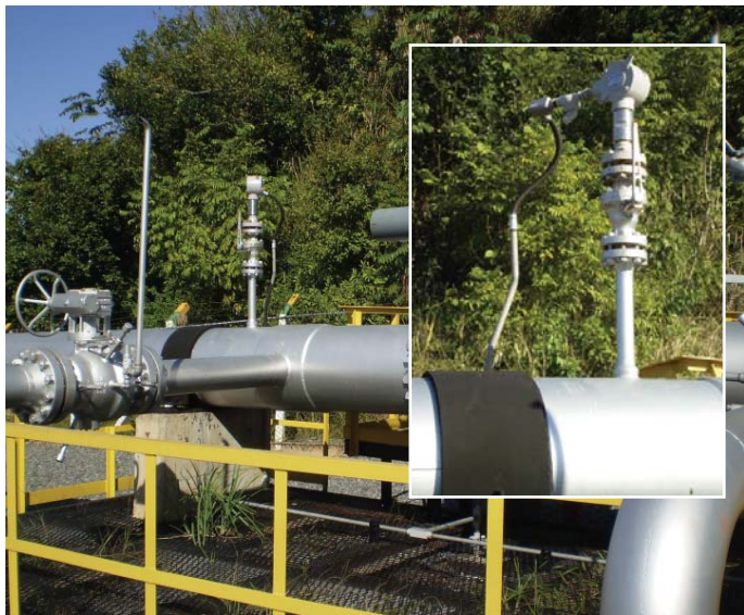
Figura 4: Sensores acústicos instalados em campo.
