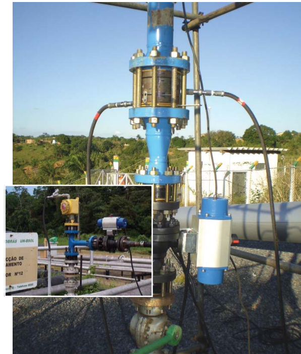
Figura 11: Kit de testes instalado na linha.
