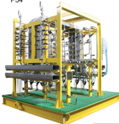
Injeção de Químicos P54
